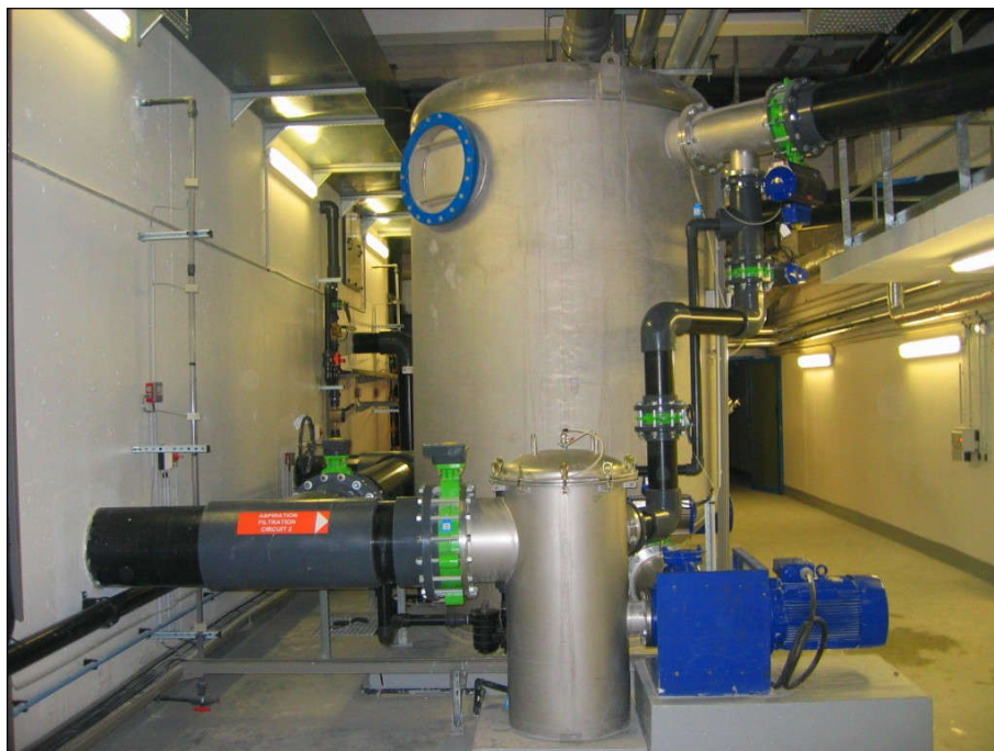
La pompe et le préfiltre, Filtre 88M installé à la piscine de Neuilly-Sur-Seine
