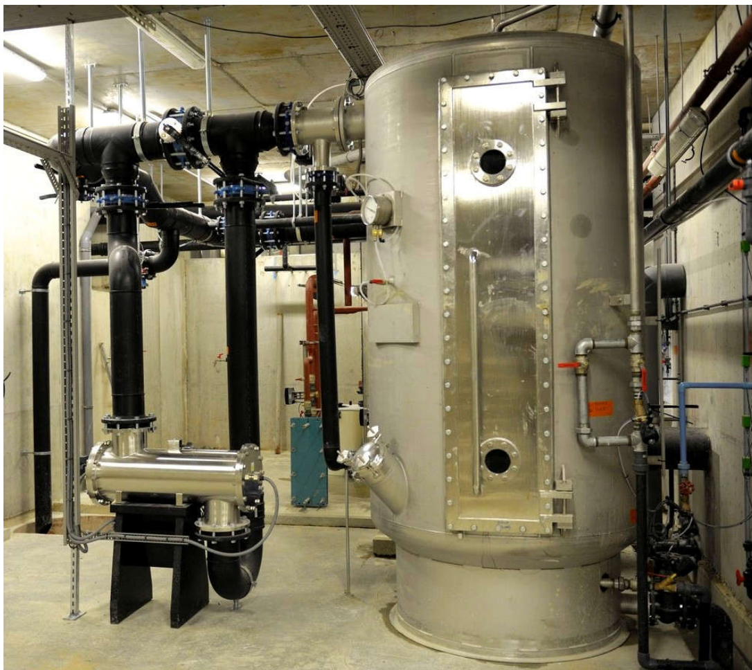
Un déchloramineur DC-CIFEC INOX 316L à gauche, un filtre à diatomées 44M CIFEC INOX 316L à droite (Q=220m 3 /H) pour le célèbre site de Vitam'Parc, en Haute-Savoie. (Bassins INOX).
